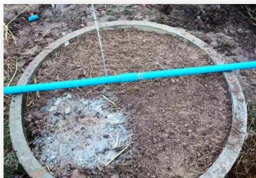
ภาพที่ 2.5 การวางท่อ PVC ตามแนวการวางบ่อซีเมนต์
